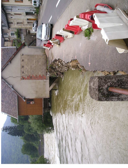
Érosion de berges à Lods (25) - 2006 (Source DLA)
