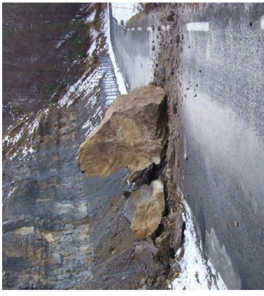
Éboulement d'un rocher le 02/12/2009, Plaimbois (25), (source gendarmerie)
