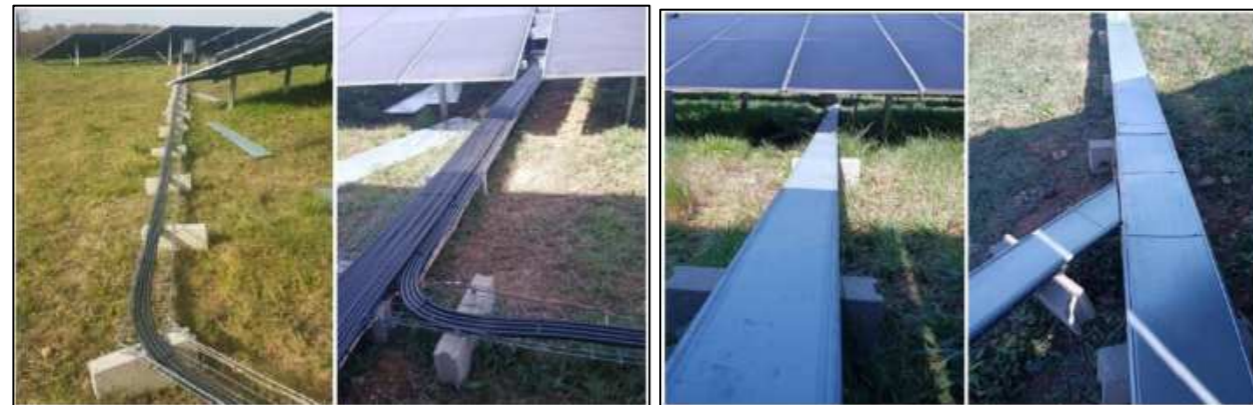
Figure 18 : Exemple de cheminement en aérien pour passages des câbles (Source : ABO Energy)
