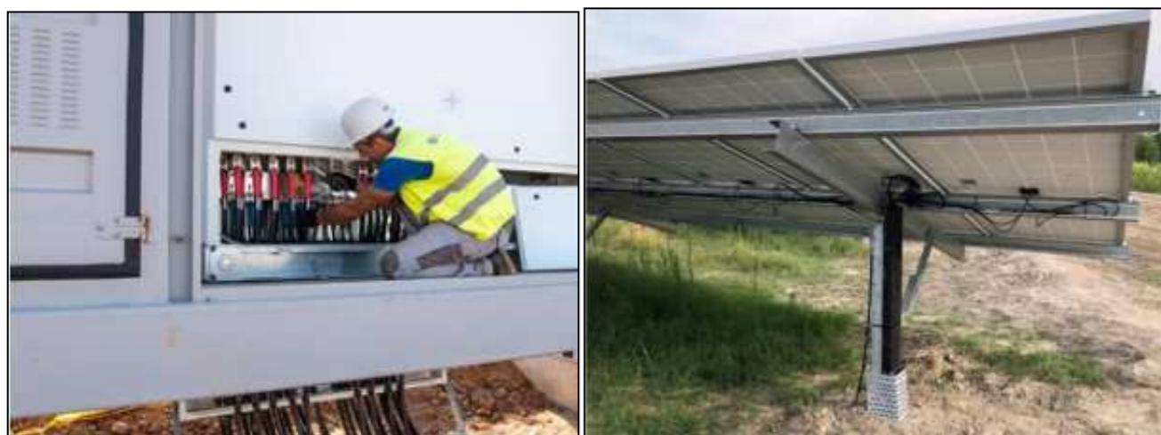
Figure 46 : Raccordements électriques (Source : ABO Energy)
