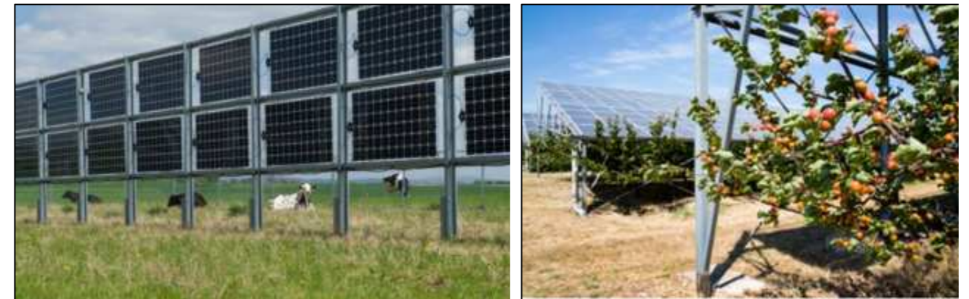
Figure 29 : Exemple de tables PV (Source : ABO Energy)
