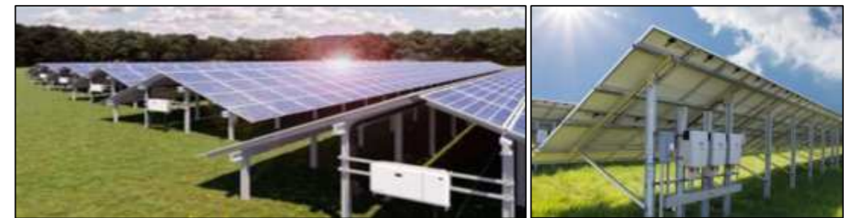
Figure 25 : Exemples d'onduleurs décentralisés répartis sur l'aire de la centrale photovoltaïque (Source ABO Energy)
