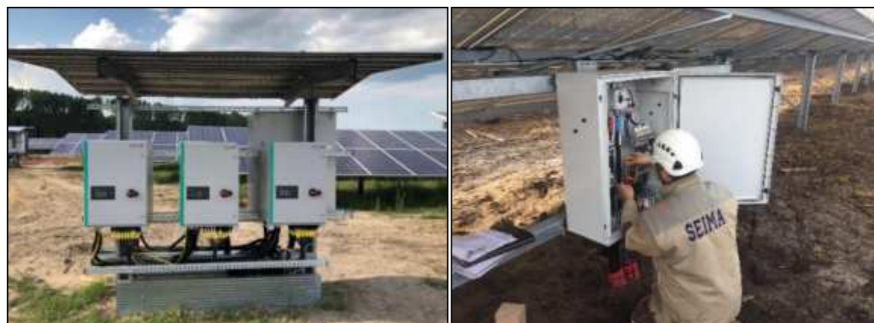
Figure 45 : Pose et câblage des boîtes de jonctions et/ou des onduleurs (Source : ABO Energy)
