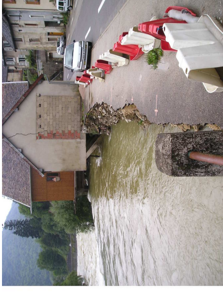
Érosion de berges à Lods (25) - 2006 (Source DLA)
