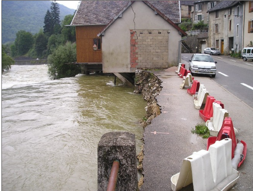
Illustration 8: Érosion de berges à Lods (25) - 2006 (Source DLA)
