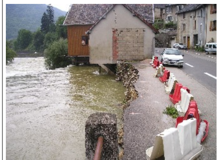
Érosion de berges à Lods (25) - 2006 (Source DLA)
