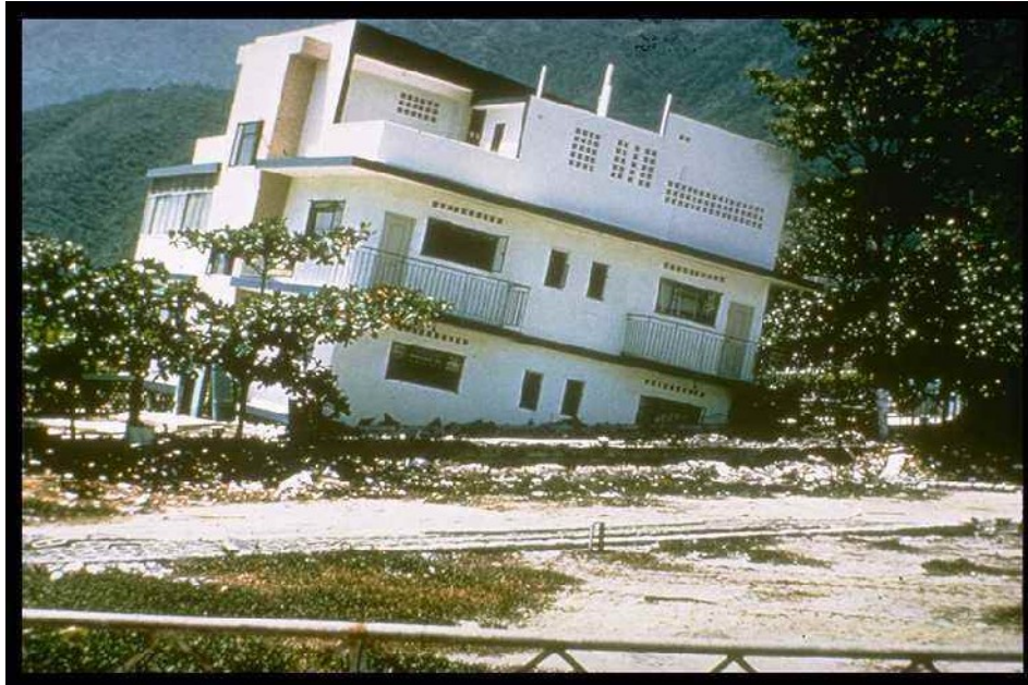
Illustration 9: Liquéfaction des sols suite au séisme de Caracas (Vénézuéla) en 1967 (Source USGS)
